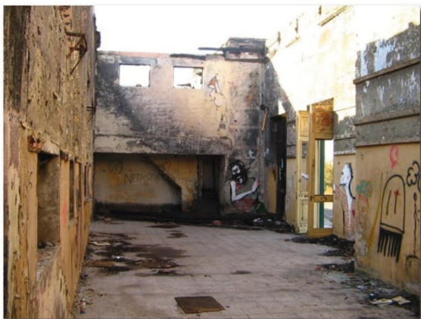
Ilustración 11: Estado del interior del Edificio de la Estación FFCC de Ciudad- Mendoza, previo a su clausura en 2010.-
